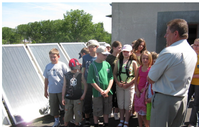
Uczniowie oglądają kolektory słoneczne w Domu Pomocy Społecznej w Nowej Wsi Elckiej
